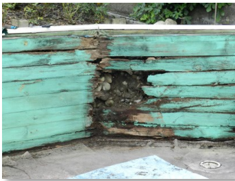
Ein durch Feuchtigkeit im Erdreich verfaultes
